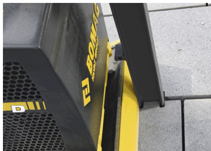
Keine Beschädigungen an Einbauten und Rändern
